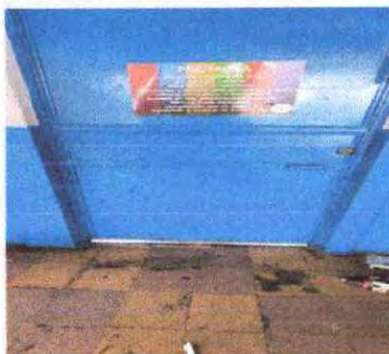
Foto .Guarda polvos en las puertas para evitar que eantren roedores en los salón de clases y eb cocina
