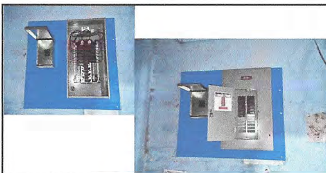
Foto 12: TABLEROS COLOCADOS Y LISTOS.
