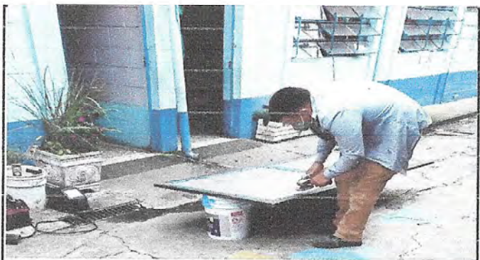
Foto 3: LAMENTABLEMENTE ESTABA MUY OXIDADA Y EL MATERIAL YA ESTABA OBSOLETO, SE HIZO NUEVA PUERTA CON CHAPA.
