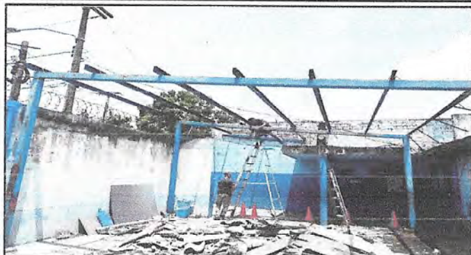
Foto1: SE HA QUITADO TODA LA LAMINA, ESTABA YA POROSA.
