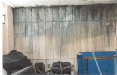
Foto 2: pared con filtracion de agua
