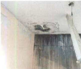
Foto 3: filtracion de agua techo
