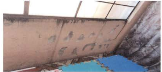
Foto 2: filtraciones por lluvia
