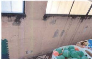
Foto 1: filtraciones por lluvia
