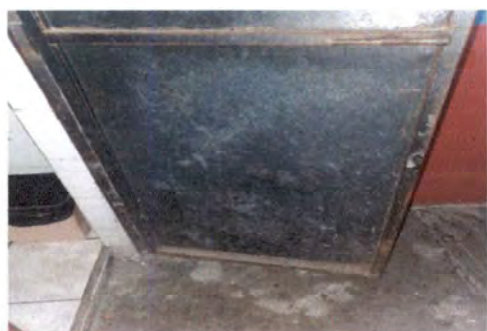
Foto 5: PUERTA DE SANITARIO PRIMER NIVEL
