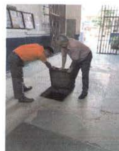
Foto 16: Cisterna de Agua
