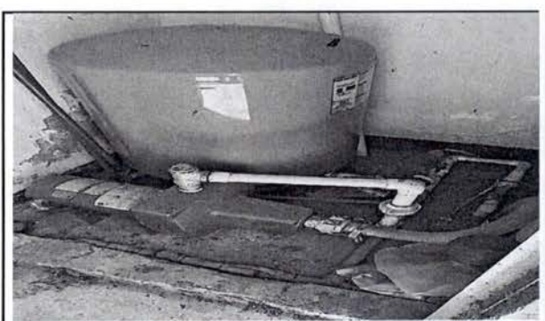
SUMINISTRO DE HIDRONEUMÁTICO
