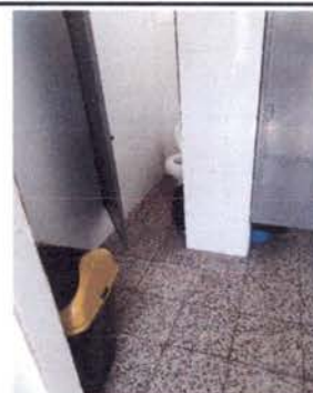
Foto 4: RENGLÓN 10 "SERVICIOS SANITARIOS Y SUS ACCESORIOS"
