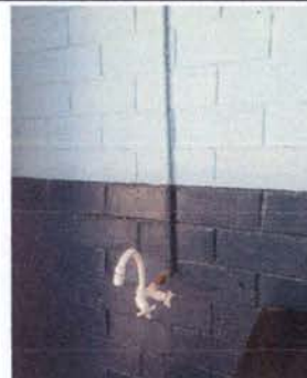
Foto2: RENGLO 20 "SUSTITUCIÓN DE PILA"
