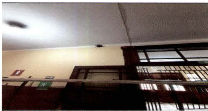
UBICACIÓN DE CAJA DE REGISTRO GENERAL
