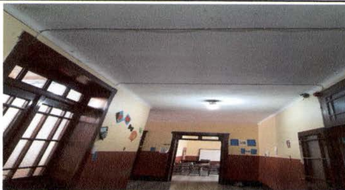
CABLEADOS SOBRE PUESTOS ACTUALES
