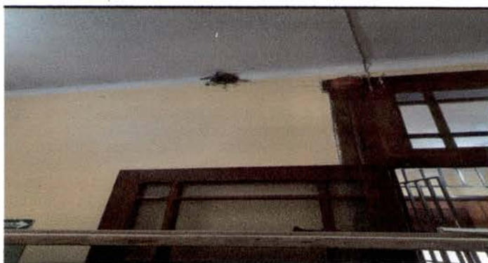
UBICACIÓN DE CAJA DE REGISTRO GENERAL
