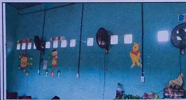
Foto 5: Sistema eléctrico instalado
