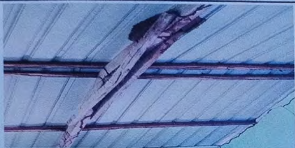
Foto 1: Vigas en mal estado
