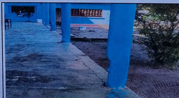
Foto 6: Las cinco columnas a punto de quebrarse en su totalidad
