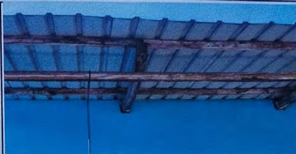
Foto 2: Vigas torcidas por el mal estado y calor
