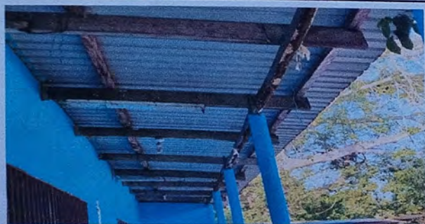
Foto 3: Techo en mal estado
