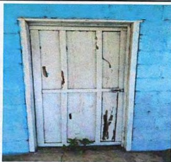
Foto 3: Sustrucción de puerta
