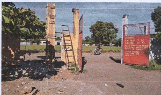
Foto 1: 4.5 Sustrucción de porton de metal
