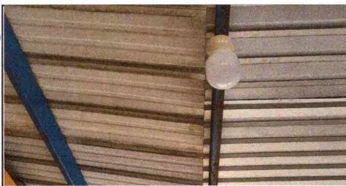
Foto 5: Instalación eléctrica, área del corredor
