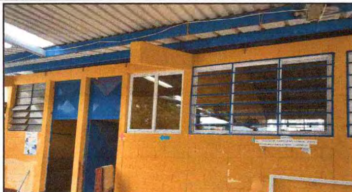
Foto1: Pendiente ventana, área de sanitarios.
