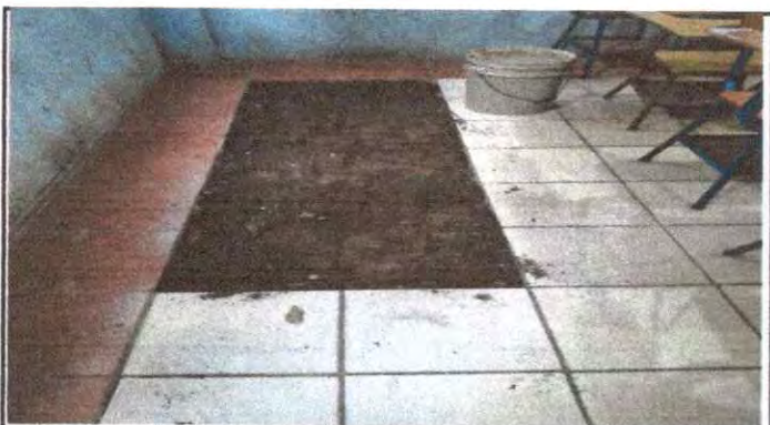
Foto 3: Sustrucción de piso cerámico.
