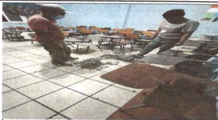
Foto 2: Sustrucción de piso cerámico.
