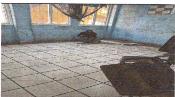
Foto 4: Sustrucción de piso cerámico.
