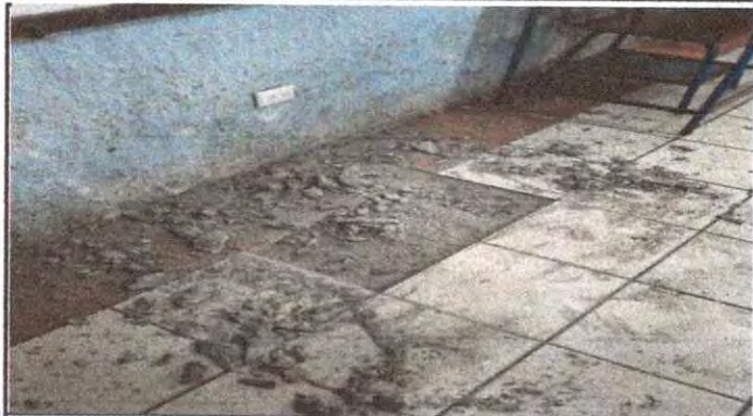
Foto1: Sustrucción de piso cerámico.
