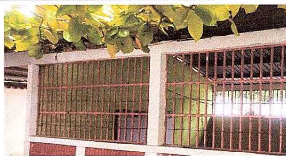
Foto 4: Balcones en mal estado, Region 5.7 (Mantenimiento de balcones de metal)
