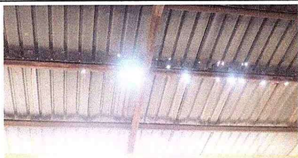
Foto 3: Estructura portante en mal estado, Region 2.2 (Sustitución de estructura de soporte de metal por metal) Region 19.7 (Instalación de estructura portante de metal) Region 19.9 (Desinstalación de estructura)
