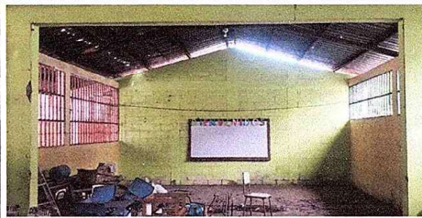
Foto 6: Muros dañados, Region 15.1 (Reparación de muro perimetral de block)
