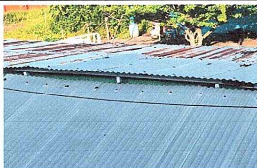
Foto 3: Capote desprendido, Region 1.2 (Sustitución de capote de lamina para lamina troquelada).
