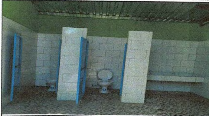
Foto 7: 10 SERVICIOS SANITARIOS Y SUS ACCESORIOS
