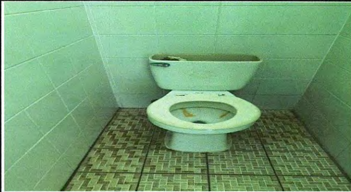
Foto 7: 10 SERVICIOS SANITARIOS Y SUS ACCESORIOS.
