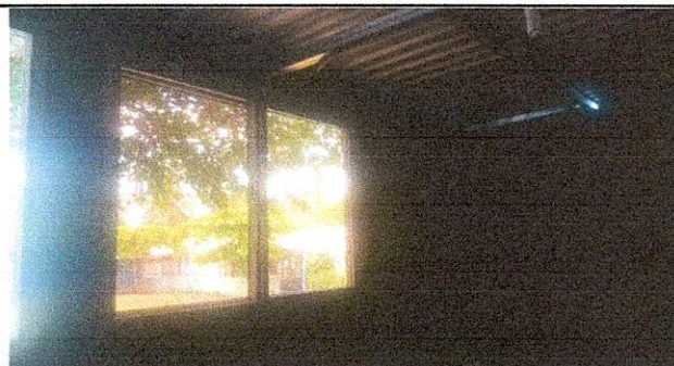
Foto 2: Ventanas de PVC para la ventilación.
