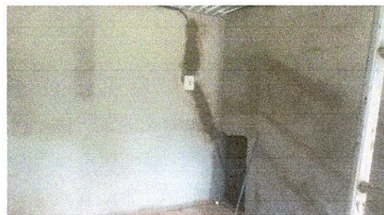
Foto 6: Plafoneras en mal estado, Region 17.5 (Sustitución de plafoneras) Region 19.11 (Instalación de unidades luz (incluye interruptor, ducto y cable eléctrico))
