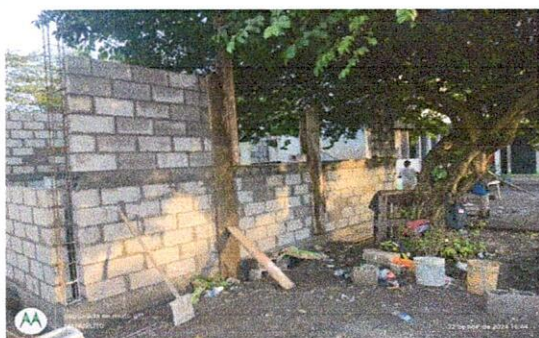
Foto 5: Muro en mal estado, Region 15.1 (Reparación de muro perimetral de block) Region 21.2 (Cernido en muro)
