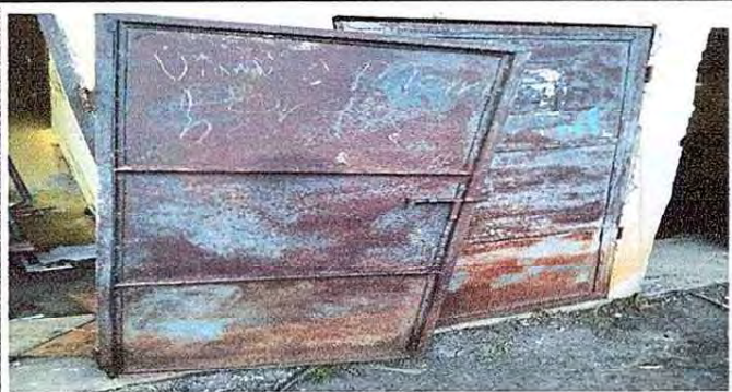
Foto 3: 4. Puertas de Metal
