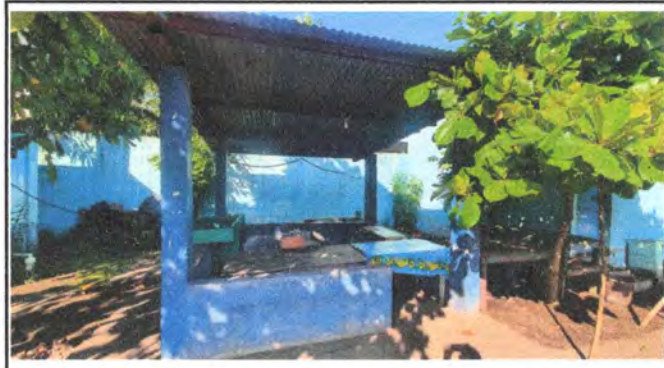
Foto 6: cocina existente con medio muro y techo de lamina en mal estado
