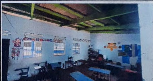
Foto 6. AULA CON NECESIDAD DE CAMBIO DE TECHO
