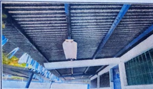
Foto 9. PASILLO CON NECESIDAD DE REMOZAMIENTO EN ESTRUCTURA
