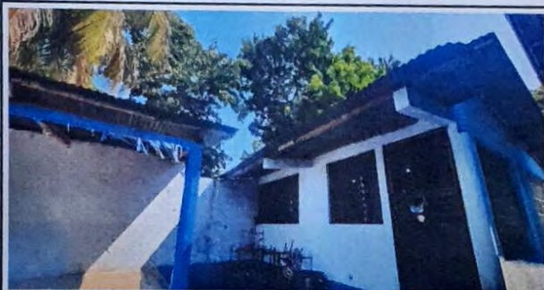
Foto 5. AULA A LA QUE SE LE REALIZARÁ CAMBIO DE TECHO
