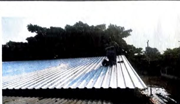
Foto 1: 1.1 SUSTITUCIÓN DE LAMINA, ESTADO ACTUAL
