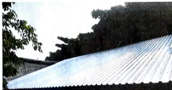
Foto 2: 1.1 SUSTITUCIÓN DE LAMINA, ESTADO ACTUAL
