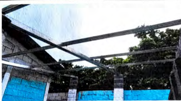
Foto 2: 1.1 SUSTITUCIÓN DE LAMINA, ESTADO ACTUAL
