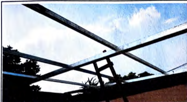
Foto 1: 1.1 SUSTITUCIÓN DE LAMINA, ESTADO ACTUAL
