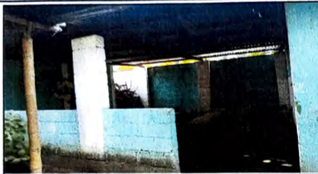
Foto1: 1.1 SUSTITUCIÓN DE LAMINA, ESTADO ACTUAL
