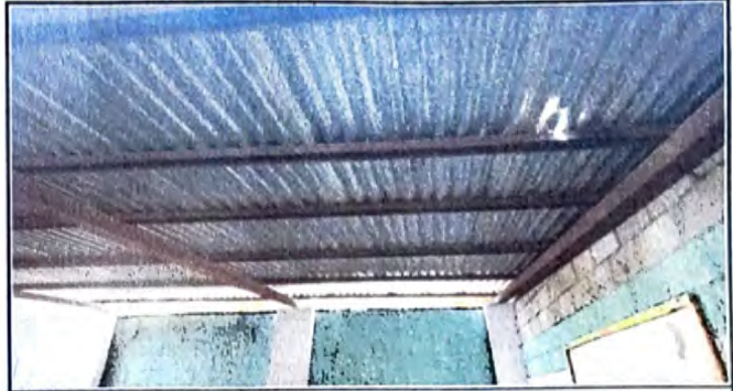
Foto 2: 1.1 SUSTITUCIÓN DE LAMINA, ESTADO ACTUAL
