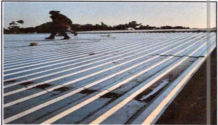
Foto1: 2. CUBIERTA DE LÁMINA Sustitución de lámina, por lámina troquelada aluzinc calibre 26 1.2 Sustitución de capote de lámina para lámina troquelada 1.3 Sustitución de elementos de fijación
