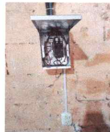
Foto 6: SISTEMA ELECTRICO FINALIZADO
