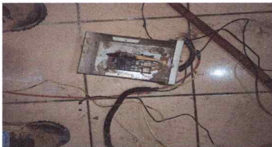
Foto 5: S CAJA DEL SISTEMA ELECTRICO
