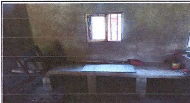
Foto 10: 21.1 Repello en muro (paredes de cocina)
