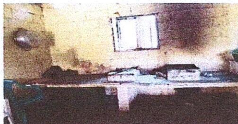
Foto 10: 21.1 Repello en muro (paredes de cocina)
