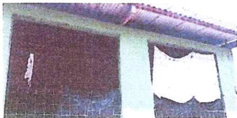
Foto 3: LOS HIERROS EN MAL ESTADO.
