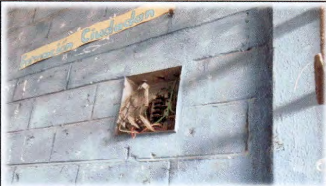
Foto 7: Es necesario el cambio de tablero de flipones y flipones.
