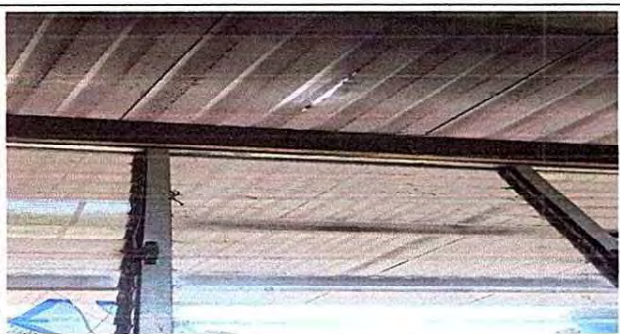
Foto 3: Sustrucción de lámina troquelada, módulo 6
