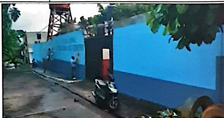
Foto 8: Pintura en muro perimetral mas rotulación.
