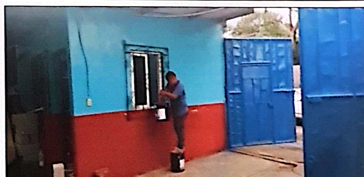
Foto 10: se observó el Remanente Pintura en exterior en el establecimiento.
