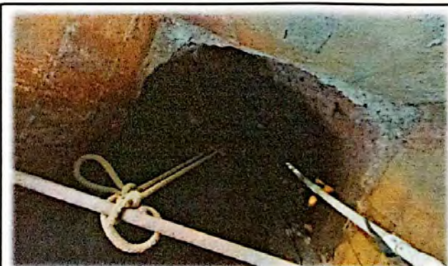
Foto 4: Es necesario el cambio e instalacion de bomba sumergible de 1 HP, incluye conexión de tubería y sistema eléctrico.
