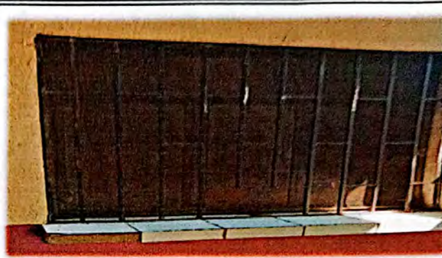
Foto 8: Es necesaria la reparación y mantenimiento de puertas y balcones.
