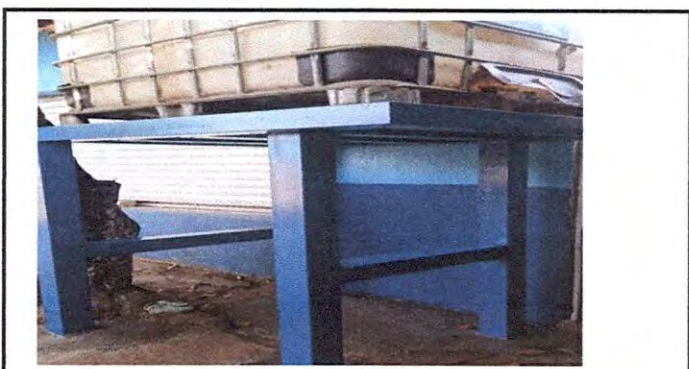
Foto 6: Elevación de depósito de agua potable
