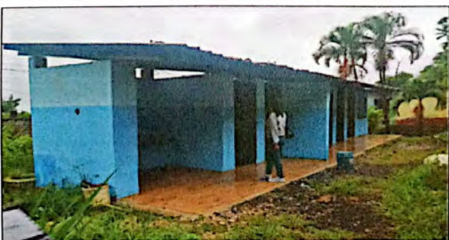
Foto 3: Servicios sanitarios hombres y mujeres, se analizan las mejoras conforme lo indica la PRA-FOR-85.
