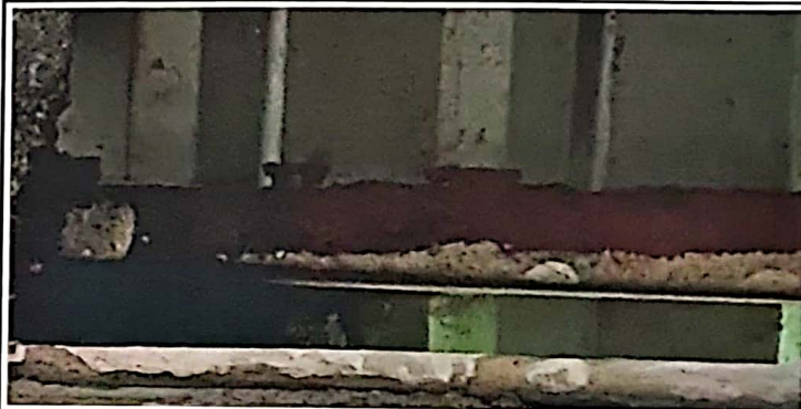
Foto 8: Se sustituirá algunas estructuras de metal por metal en cubierta, porque se encuentran en mal estado.
