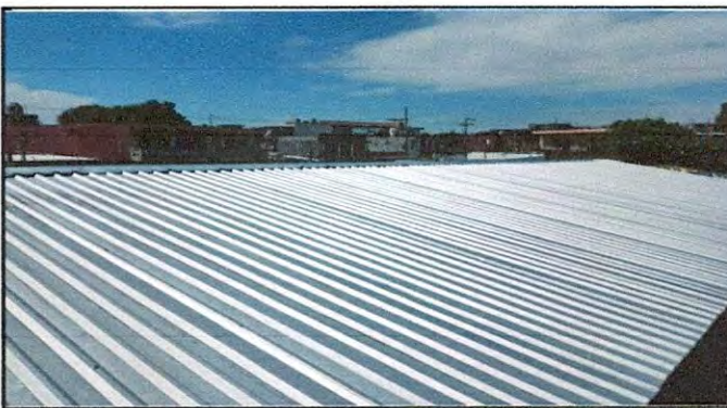
Foto 6: Techo de los salones a remozar
