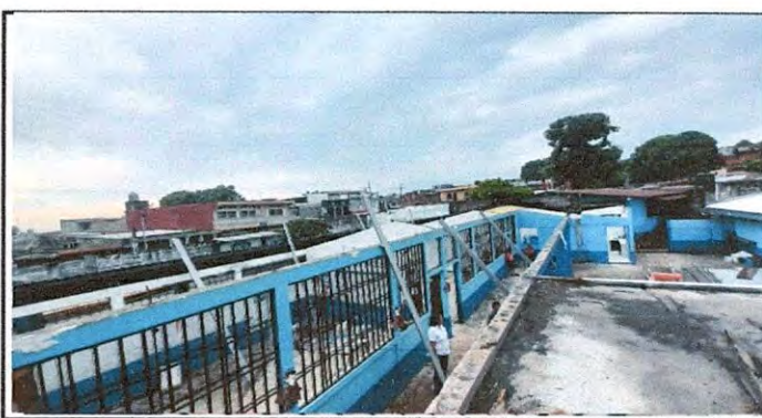
Foto 6: Techo de los salones a remozar
