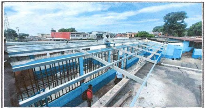
Foto 6: Techo de los salones a remozar
