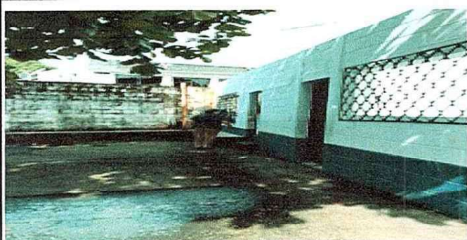
Foto 1: Vista frontal de aulas afectadas por las fuertes lluvias del 12/07/2024
