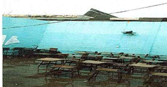
Foto 4: Salon No. 2 a remozar, de los cuatro afectados por las fuertes y lluvias y vientos del 12/07/2024
