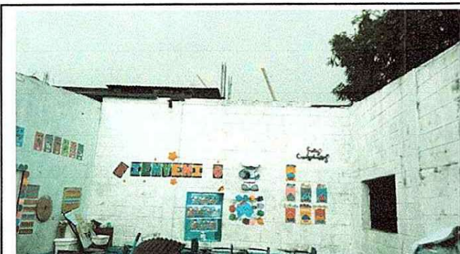
Foto 3: Salon No. 1 a remozar, de los cuatro afectados por las fuertes y lluvias y vientos del 12/07/2024
