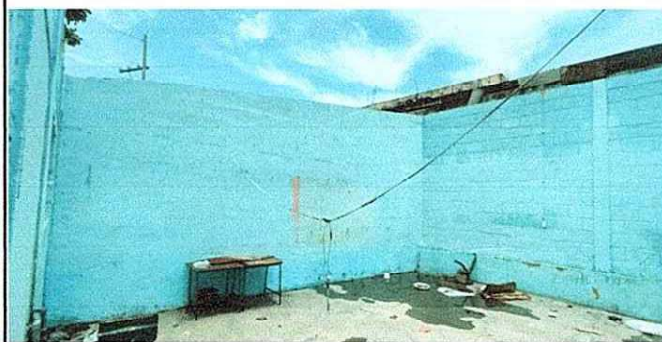
Foto 6: Salon No. 2. a remozar, de los cuatro afectados por las fuertes y lluvias y vientos del 12/07/2024
