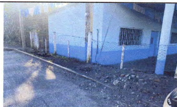
Foto 6: Perimetro de malla en mal estado
