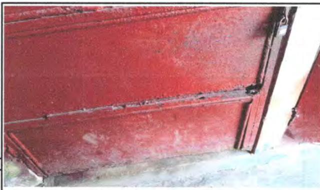
Foto 3: Puerta de baño en mal estado
