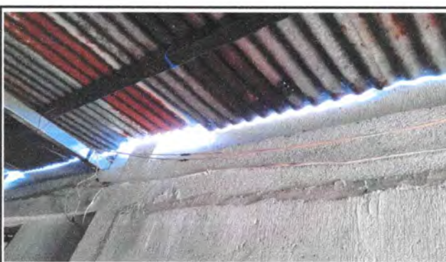
Foto 6: Techo y estructura en mal estado y mala instalación
