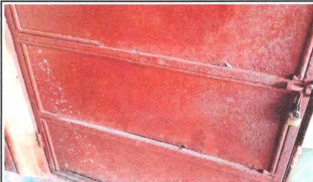
Foto 2: Puerta de baño en mal estado
