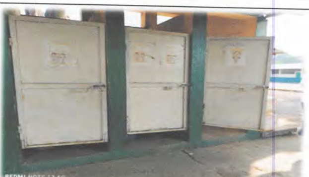
Foto 4: Se Evaluó la necesidad de reparar y darle mantenimiento a las puertas metálicas del módulo de baños.
