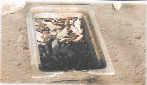
Foto 3: Caja de registro (0.40m x 0.45m) se requiere cambio e instalación de la tapadera.
