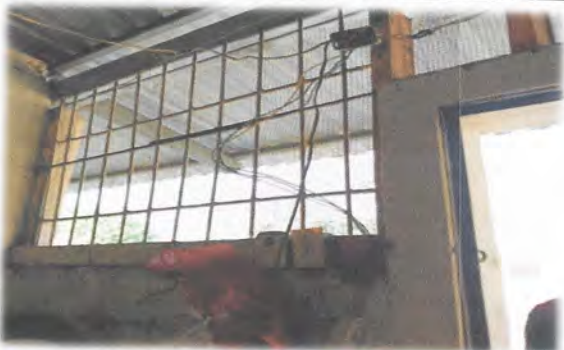
Foto 9: Es necesaria una intervención en el suministro e instalación del sistema eléctrico (fuerza e iluminación) incluyendo sus accesorios.
