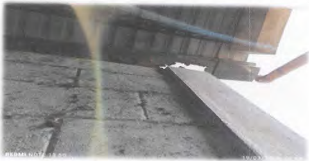
Foto 11: Es necesario cambiar los soportes de canal, el canal de PVC y las bajadas de agua pluvial PVC 3".
