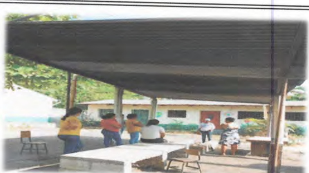
Foto 8: Es necesario cambiar la estructura de soporte de madera a metal y el cambio de lámina por lámina troquelada aluzinc calibre 26 incluyendo tornillos
