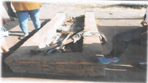
Foto 7: En el área de la cocina es necesaria la reparación de las columnas de soporte de la estructura y de la cocina rural
