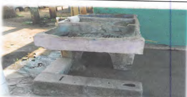
Foto 12: Se presenta la necesidad de cambio e instalación de las pilas de dos lavaderos.
