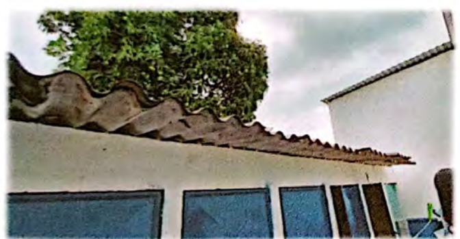
Foto 3: Mejoramiento en el 2do. módulo de servicios sanitarios. En este modulo se debe cambiar e instalar la estructura de soporte y cambiar lámina por lámina troquelada aluzinc calibre 26 (incluye pernos).
