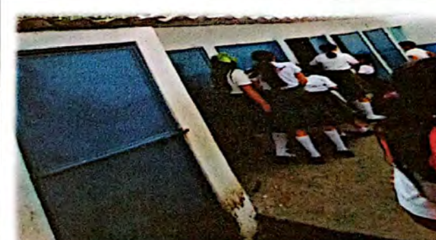
Foto 4: Se evaluó la necesidad de reparar y darle mantenimiento a las puertas de 2do módulo de servicios sanitarios.
