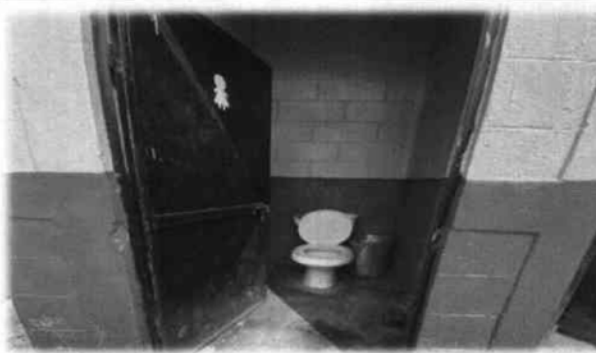
Foto 4: Cada cubículo de los inodoros no cuentan con azulejo, por tal motivo se dificulta la limpieza de los mismos.
