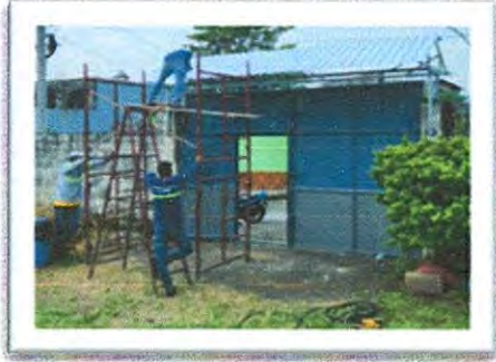
Foto 1: porton dañado por lluvia, sol colocacion de pestaña
