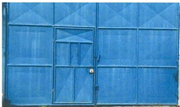
Foto 3: Corrosion en porton en estructura y lamina
