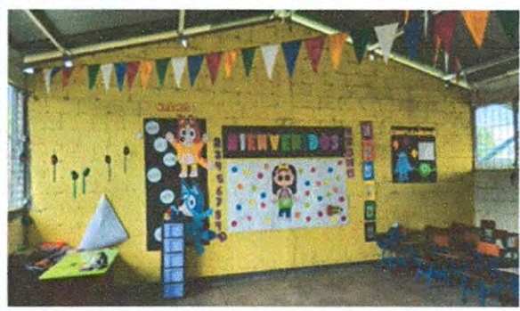
Foto 3: Paredes en mal estado , filtracion de humedad
