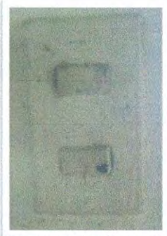
Foto 5: Interruptores dobles en mal estado por antigüedad
