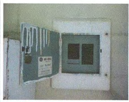
Foto1: Caja de flipones en mal estado por antigüedad se bajan solos con el calentamiento
